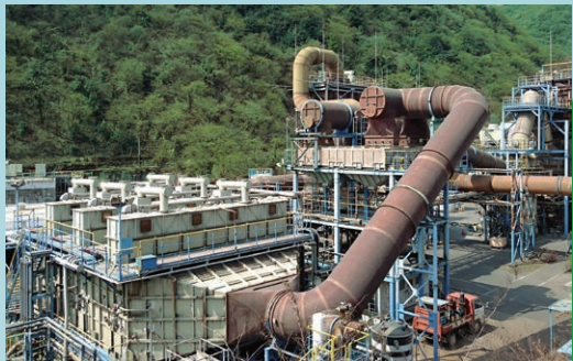
クリーンZ炉排ガス処理設備
