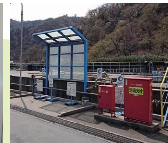
半地下式廃液タンクと消火設備
